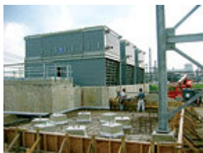
Εικόνα 10. Πύργος ψύξης κλειστού κυκλώματος εγκατεστημένος σε ένα χημικό διυλιστήριο, αποβάλλει θερμότητα από διαδικασίες θερμικών ανταλλακτών (exchangers) και σταματάει τη θερμική μόλυνση κοντινού ποταμού. Ο πύργος προστατεύει το περιβάλλον από απροσδόκητες χημικές εκπομπές απομονώνοντας το κύκλωμα ψύξης νερού (Photo courtesy of Baltimore Aircoil.)
