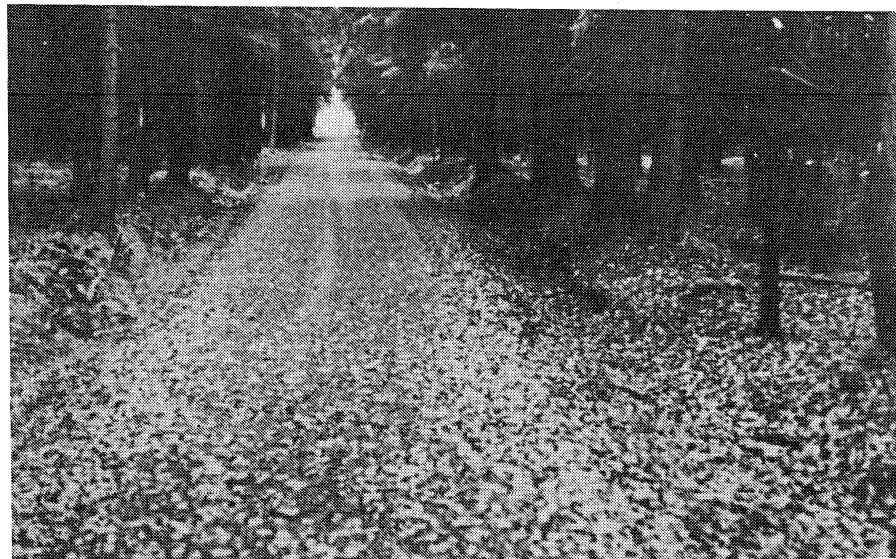
Φωτ. 1β. Ο ίδιος δασικός δρόμος μετά τη σταθεροποίηση με το υλικό. Χαρακτηριστικά αναφέρεται ότι ο δρόμος αυτός χρησιμοποιείται από βαριά στρατιωτικά οχήματα του NATO (Schwarz VBI. 1978)
