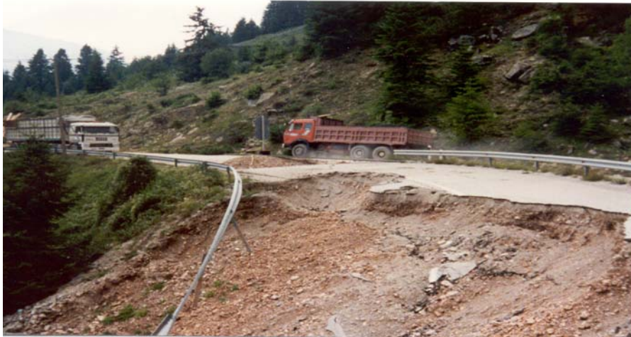
Φωτογραφία 1. Ατύχημα σε δασικό δρόμο, οφειλόμενο σε κατασκευαστικές αστοχίες. Photograph 1. Accident in forest road, owed in constructional mistakes
