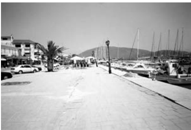
Σχήμα 5α. Λευκάδα-Οδ. Γκολέμη: Καθίζηση υλικού επίχωσης
