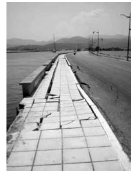
Σχήμα 5γ. Λευκάδα- Δίαυλος: Καθίζηση επιχώματος.
