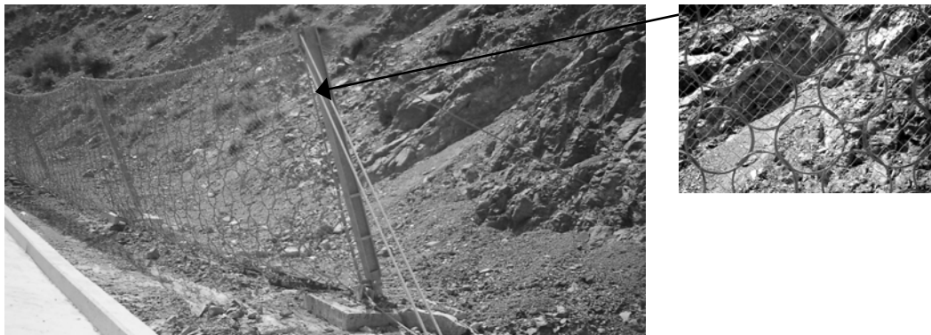
Σχήμα 11. Ελαστικός μεταλλικός φράχτης τοποθετημένος σε θέση της Εθνικής οδού Μηλιάς-Μετσόβου
