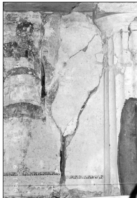
Εικόνα 14. Λεπτομέρεια της πρόσοψης του τάφου της Κρίσεως με ρωγμές λόγω διαφορικής καθίζησης του εδάφους.
