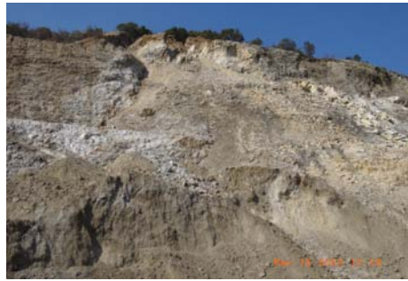
Figure 11. Glissement de terrain le long du ch. 9+700
