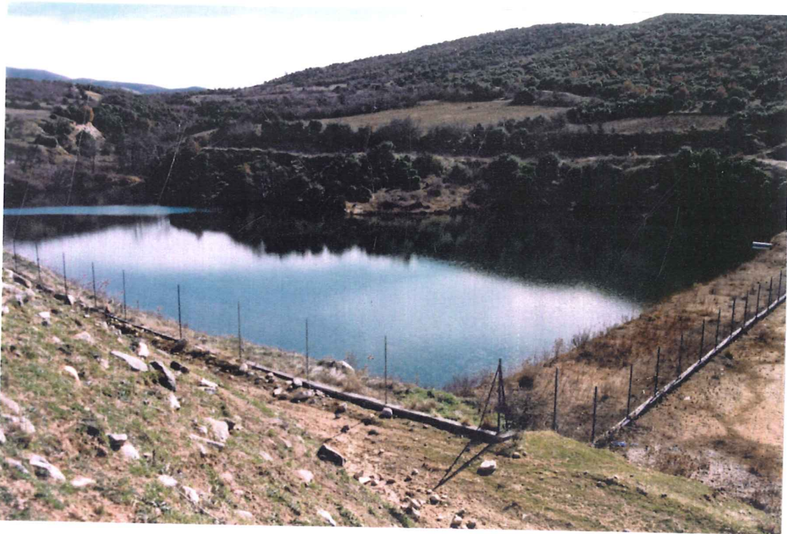
Χωμάτινος ταμιευτήρας στο Σιδηρόκαστρο (Λεκάνη απορροής χειμάρρου Μαϊμούδας). Στο δεξιό μέρος της φωτογραφίας διακρίνεται ο ακατάλληλος εκχειλιστής
